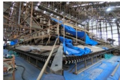
<建造物半解体修理の様子> 重要文化財 本隆寺本堂 (京都府京都市)
