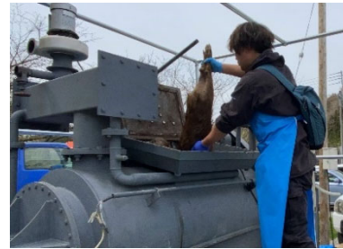
処理加工施設に設置した野生鳥獣の減容化装置
