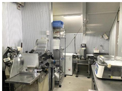
＜処理施設の内部＞
