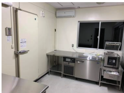
<処理施設の内部>
