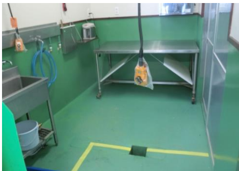
<処理施設の内部>
