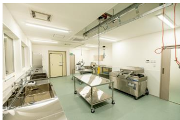
<処理施設の内部>
