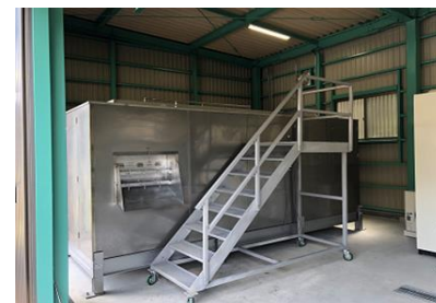
＜減容化処理装置＞
