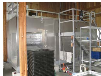
残渣処理設備
