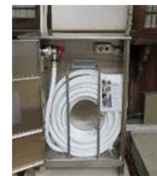
(易操作性1号消火栓)
