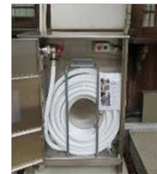
（易操作性1号消火栓）
