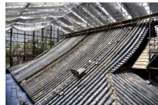
<建造物維持修理> 重要文化財 知恩院勢至堂 本瓦葺解体（京都府）
