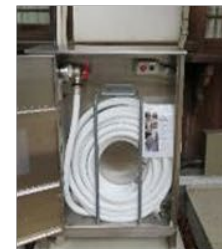
（易操作性1号消火栓）
