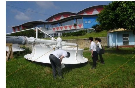
ホテル横の小型風車（写真は台風に備えて傾倒中）
