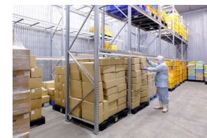
輸出を可能にした大型冷蔵設備
