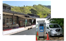
EV車等への給電設備
