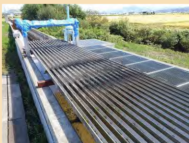
緩傾斜型スクリーン※写真は施設稼働前
