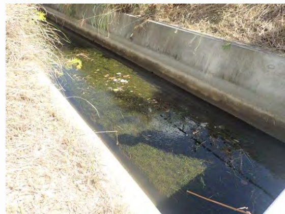
蓋掛けなし箇所(水草繁茂) 近畿農政局管内での事例
