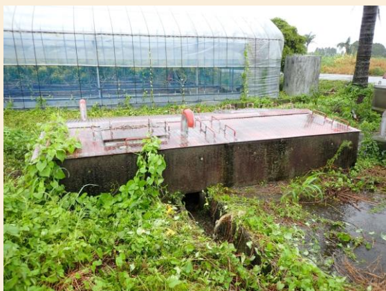
排泥工（パイプラインに併設）
