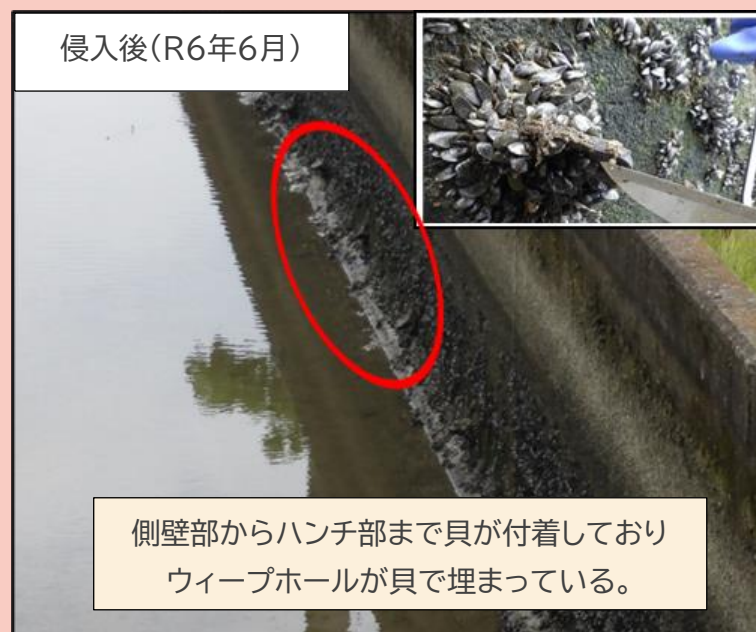
樋ノ口用水のある地点の定点写真 (上図:カワヒバリガイ侵入前のR5.5 月、下図:カワヒバリガイ侵入後の R6.6 月)
