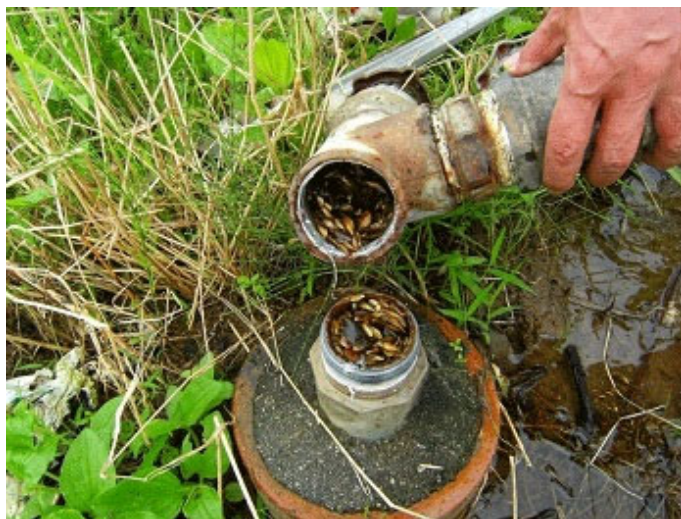
カワヒバリガイの死貝で給水栓が詰まり、取水できなくなった事例
