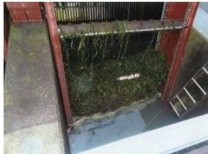
オオカナダモが除塵機に絡まりポンプが停止した事例
