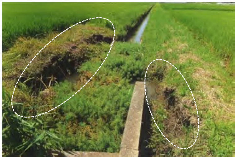
台風による大雨で、排水路の合流点にオオフサモが集積し、水が溢れて周りの畦畔が崩れた事例
