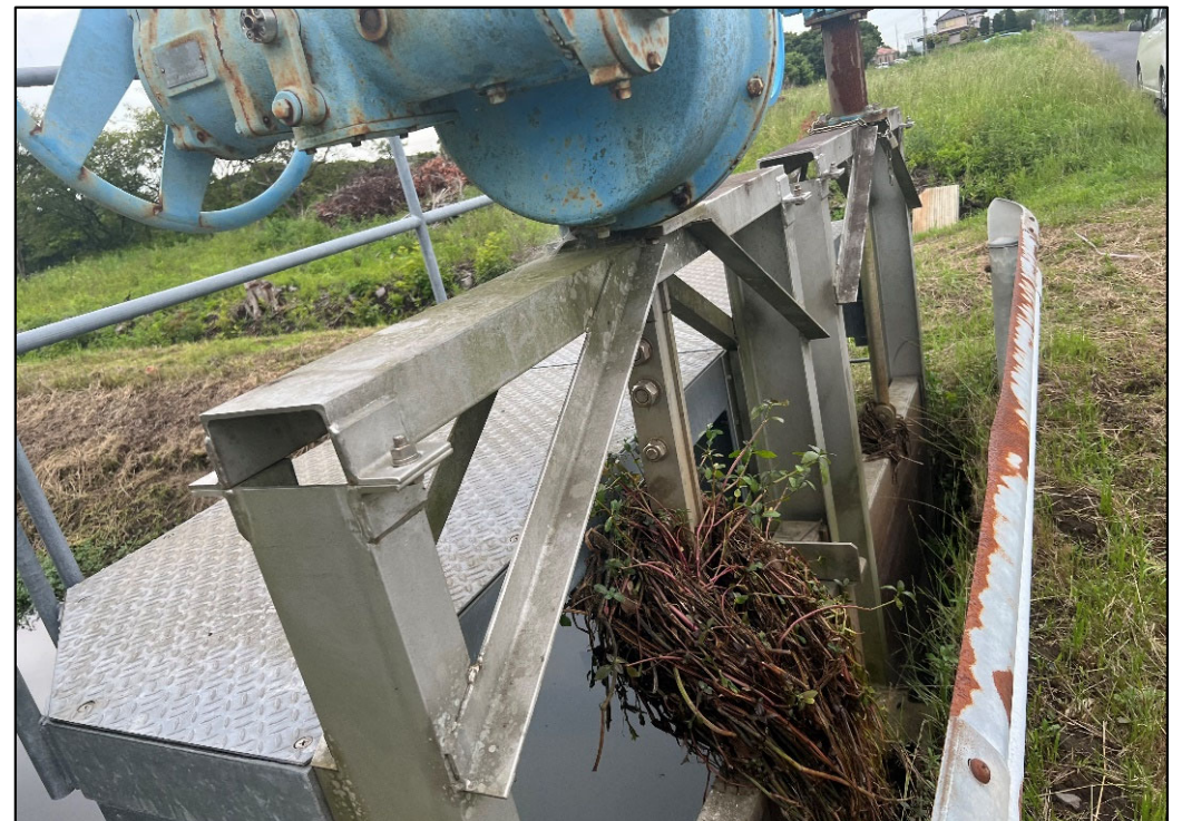
水門操作の支障になるナガエツルノゲイトウ(R5匝瑳市)
