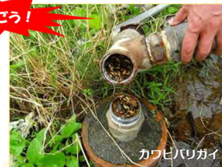
カワヒバリガイ 外来貝類による給水栓の目詰まり
