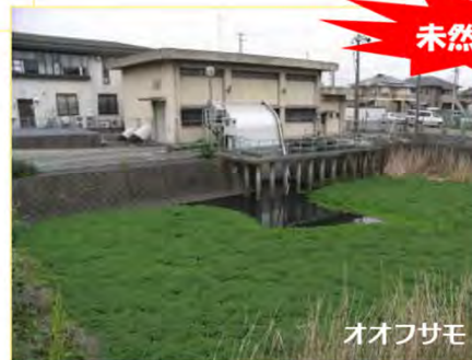
オオフサモ ポンプ場での外来植物の大発生
