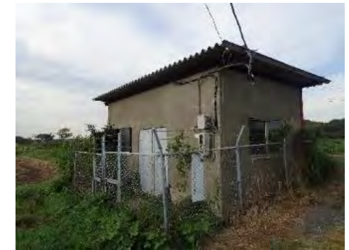
小規模ポンプ場
