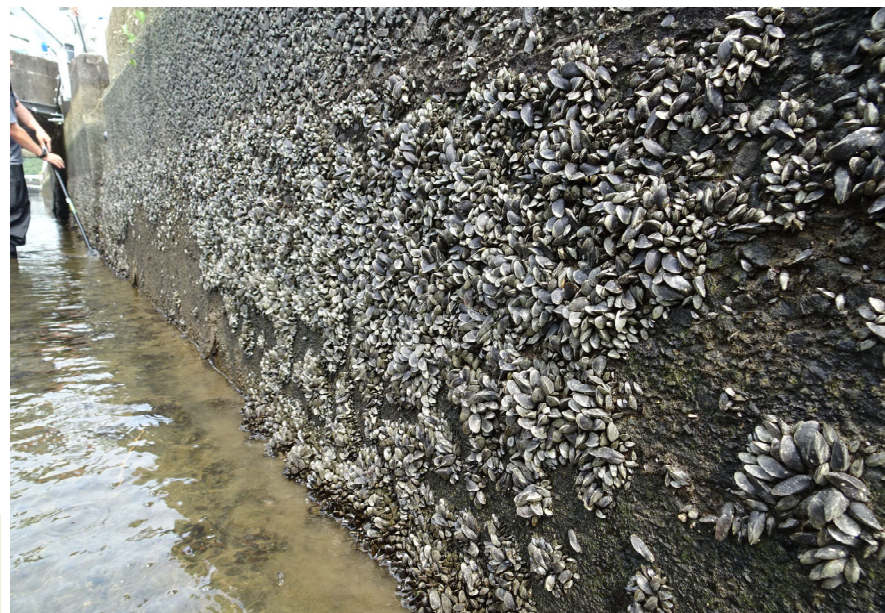
水路壁一面に付着したカワヒバリガイ
