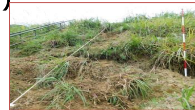
イノシシによるため池堤体の掘り返し被害の例
