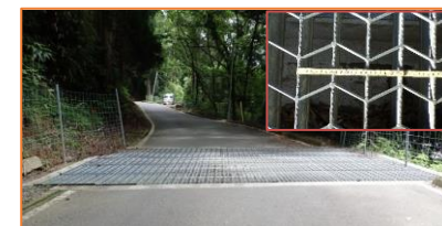
道路部に設置されたグレーチングの例
