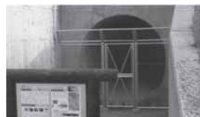
参考 2-19 バットゲートの設置状況
