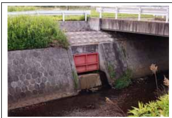
写真-3.1 幹線排水路放流口と河川との落差の例
