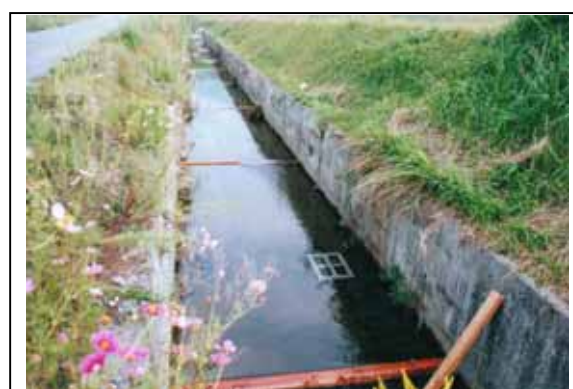
写真-4.8 枕木水路の例
