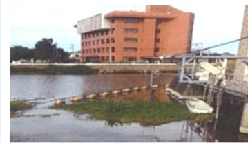
排水機場のスクリーンに集積した水草
