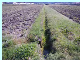
老朽化した水路
