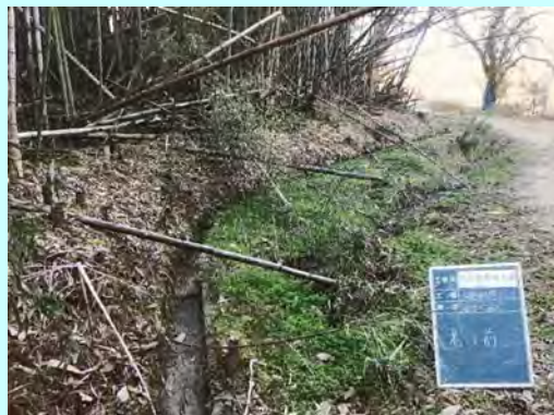
老朽化した水路
