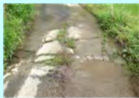
老朽化した農道
