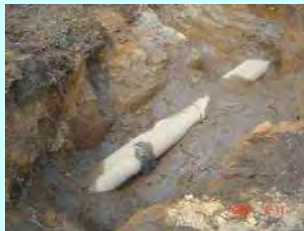
漏水したパイプライン
