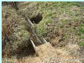
不具合箇所（水路）
