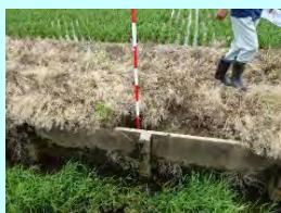
陥没した法面
