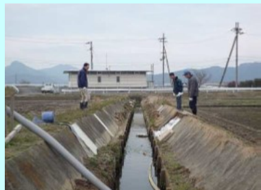
ほ場整備後の段差
