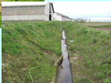
水路側壁の倒壊
