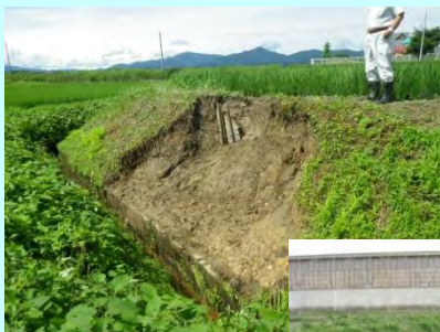
水路法面の崩壊
