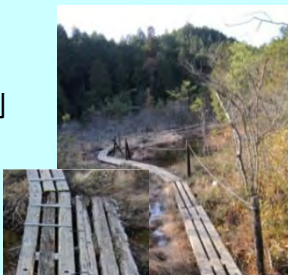
劣化の進行した木道
