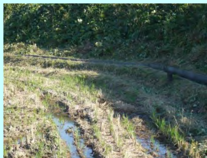
老朽化水路からの漏水状況
