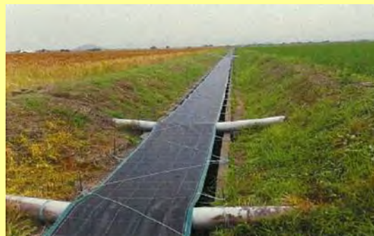
防草シートによる排水路の遮光
