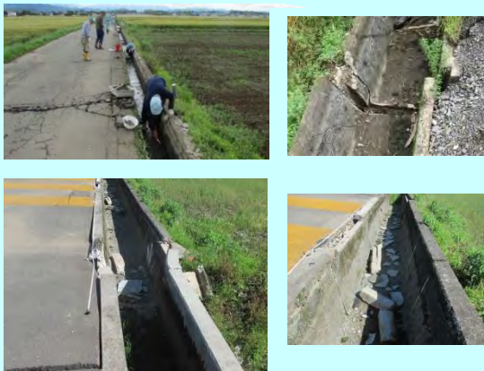
水路の損壊等の状況
