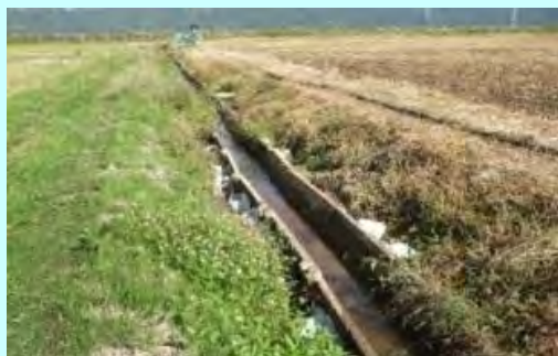
老朽化している用水路
