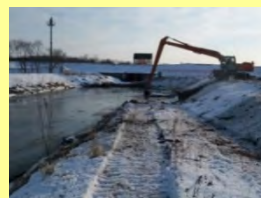
沈砂池の泥上げ （3年に1回（沈砂池数7））
