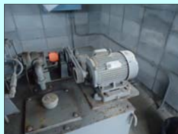
老朽化したポンプ
