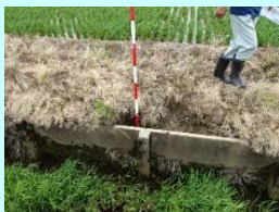
陥没した法面
