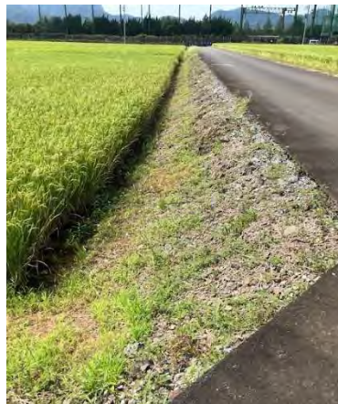
未対策の路肩
