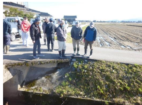
みんなで回る 地域危険箇所の点検
