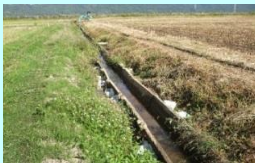
老朽化している用水路
