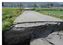
【路面の損傷】阿蘇市
