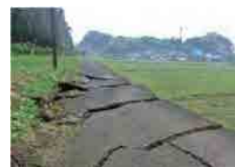
【路面の損傷】上益城郡益城町
