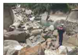
【頭首工破損】人吉市
