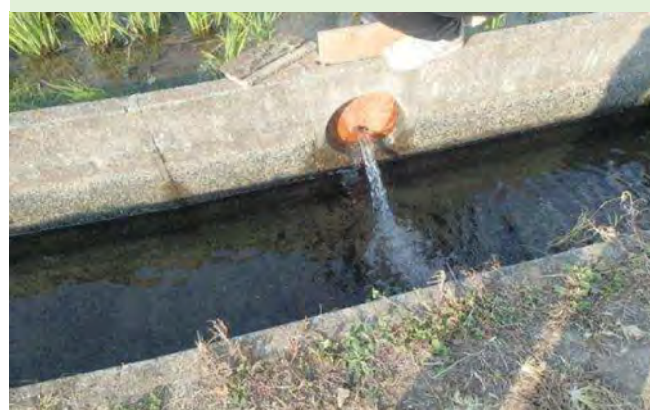
流量調整のせき板 設置あり
