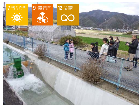
小水力発電の設置
