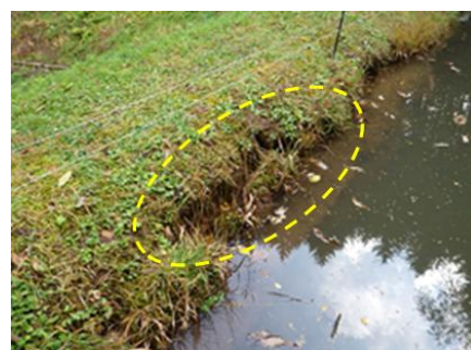
巣穴による「ため池堤体の損壊」
