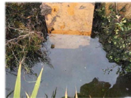
止水板による止水状況 (出典：国土強靱化民間の取組事例集)
