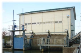
大場排水機場
